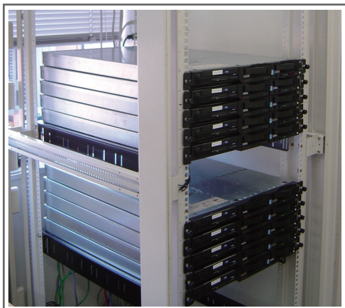
並列処理ミドルウェア「HarmonyCalc」稼働中のリユースシステム
